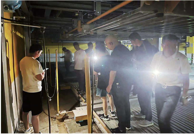
实地考察地下车库漏水情况。
